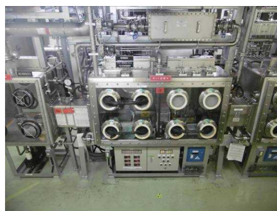
霧団気制御装置グローブボックス設備
