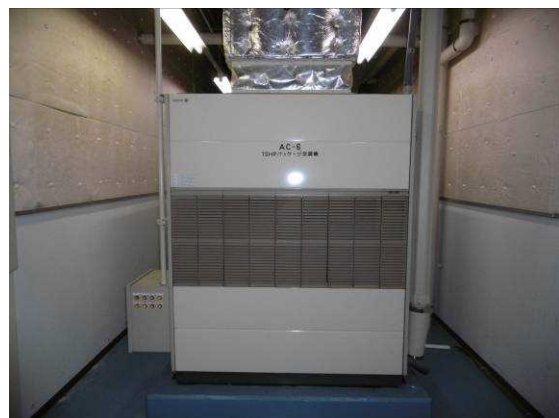
換気空調設備
