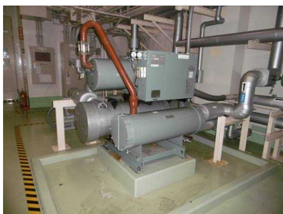
冷水・冷却水設備
