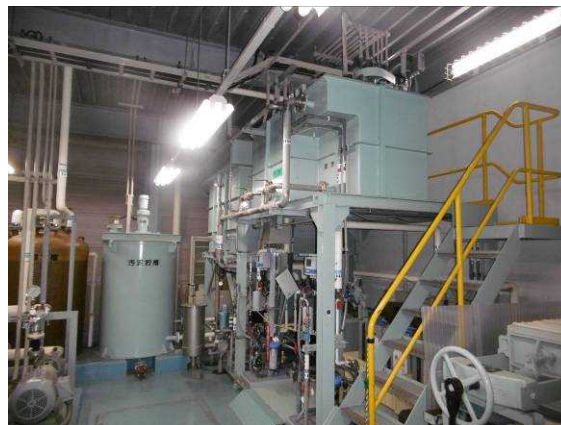
排水処理設備
