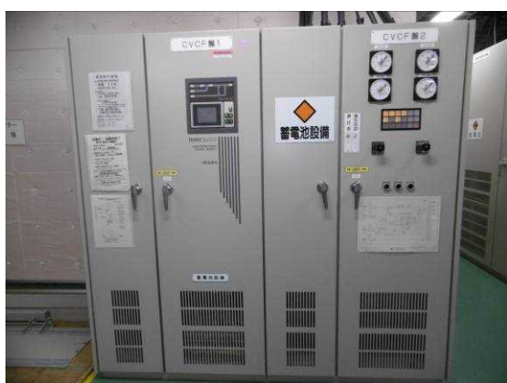
無停電電源装置設備
